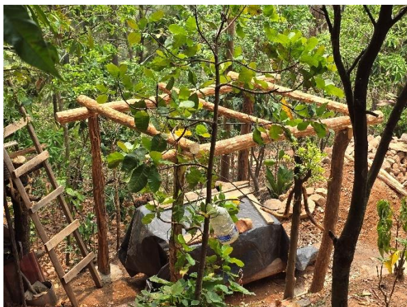
Figura 1 Avances en la construcción de la cocina solicitada en la Licencia No Comercial No. RFFM-LNC-029-2024. MFI 2024. Valle de Ángeles, F.M.
